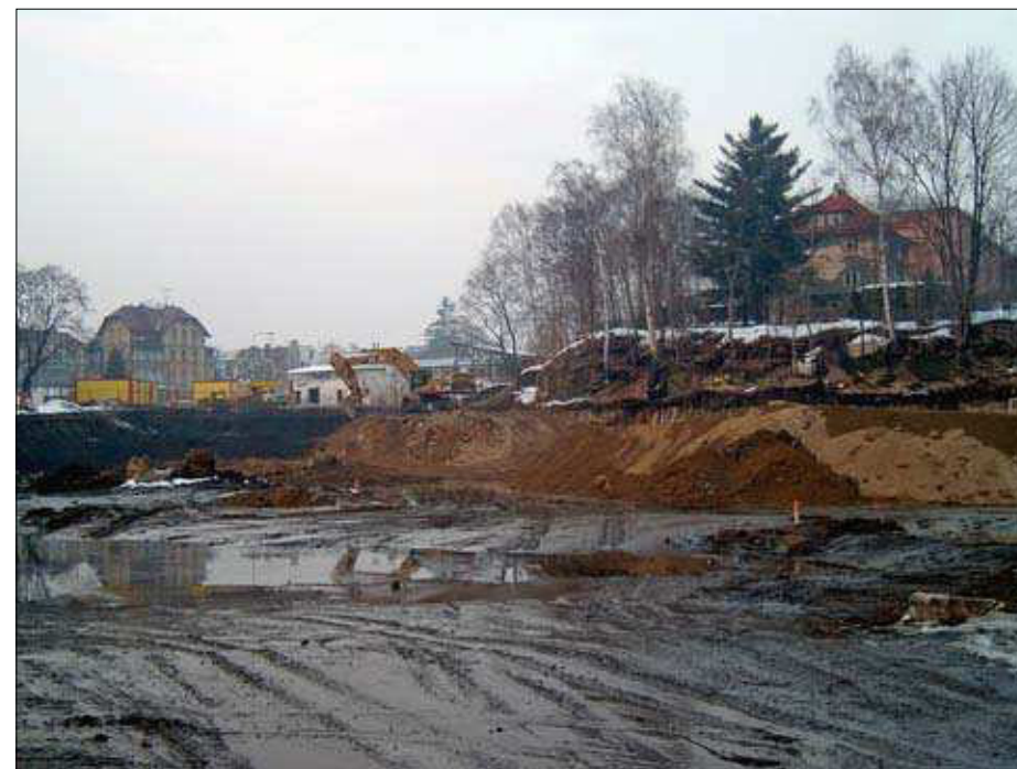
2. Zatopené staveniště Intersparu (mezi ulicemi Durychovou a Budyšínskou) na jaře roku 2006 velice připomínalo původní koupaliště.
