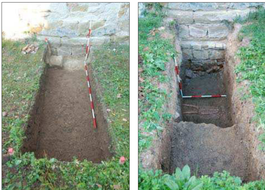
Obr. 2 a 3. Deštná (CL), kostel sv. Václava, sonda 1/07, stav během výzkumu, foto autor 17. 10. 2007 a 8. 5. 2008.
