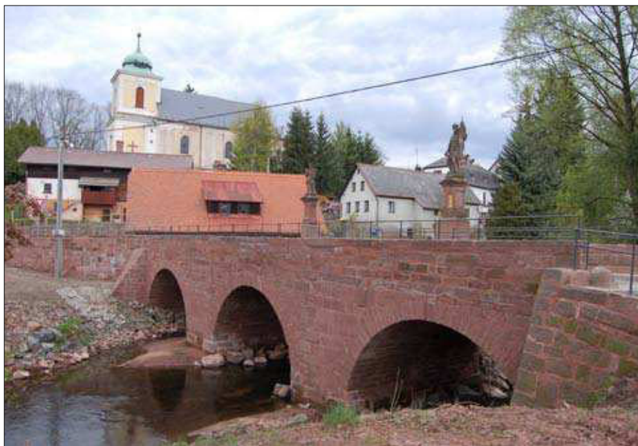
Konečný stav po opravě v říjnu 2008 (foto Tomáš Kesner).
